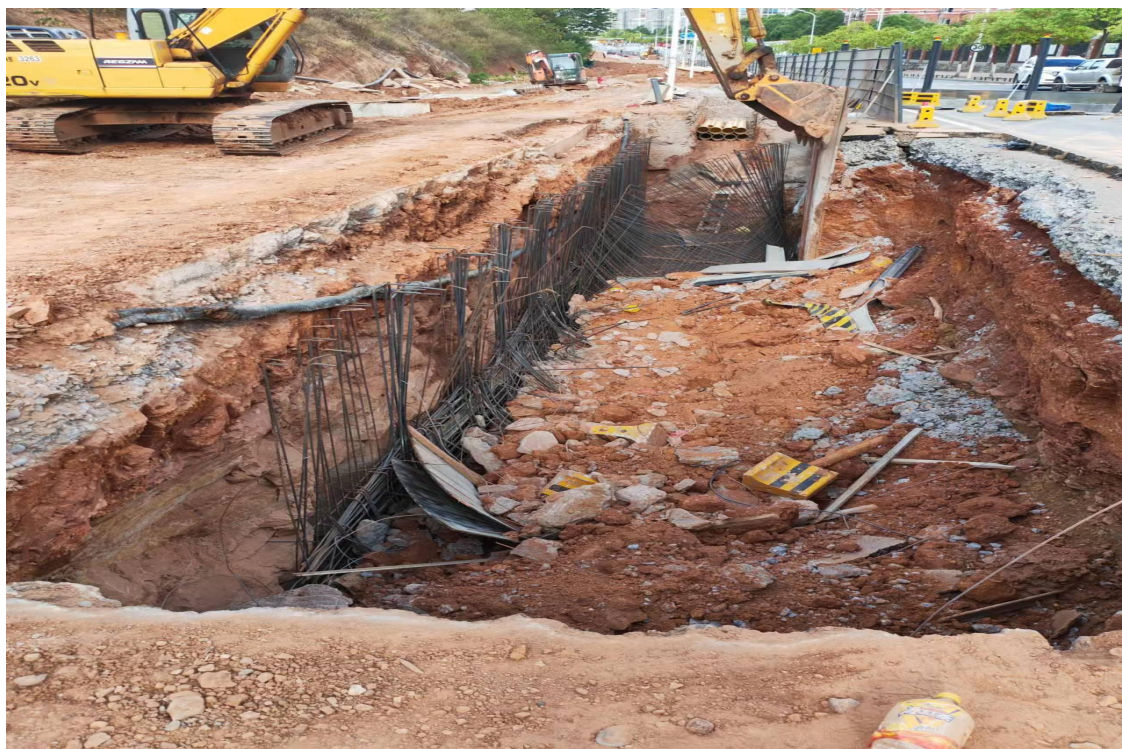
事故现场照片
